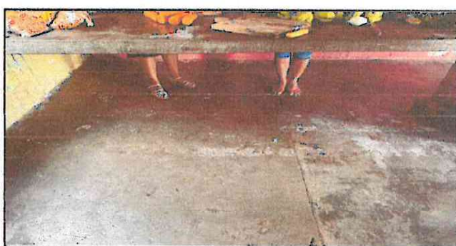
Foto 6: Comedor deteriorado de la cocina.
