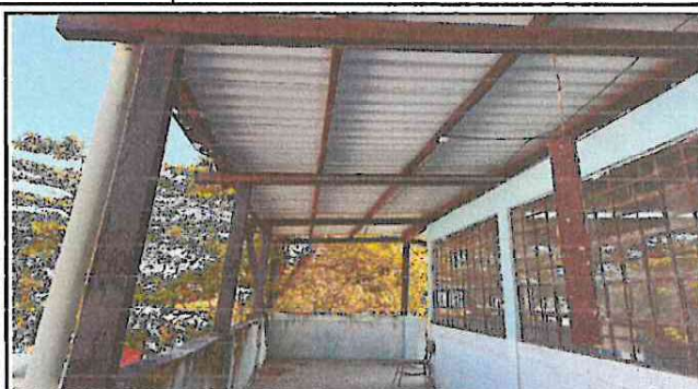
Foto 2: Laminas del corredor y cableado electrico destruido
