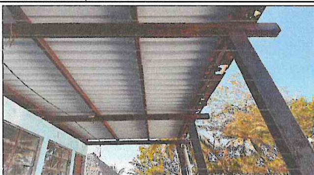
Foto 1: Lamina y estructura metalica destruida.
