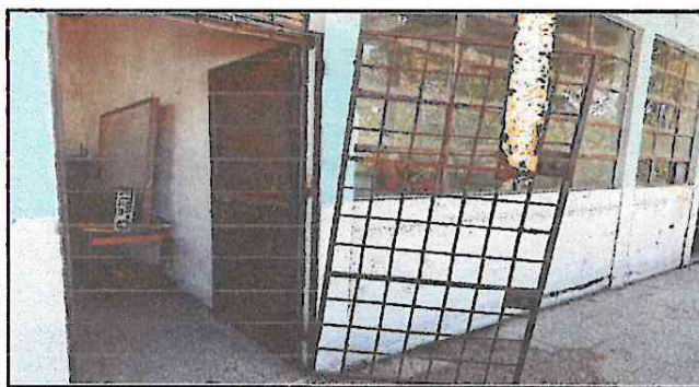
Foto 3: Puertas de entrada y salida dañadas del aula.
