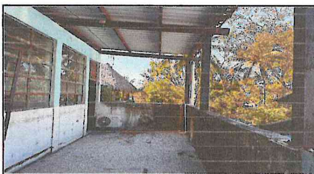
Foto 4: Pared destruida por falta de repello.
